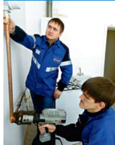
Мастер монтажной службы Сергей Королев и монтажник Илья Сологубов успешно освоили новшество
